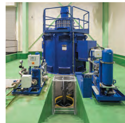
発電機及び補機
