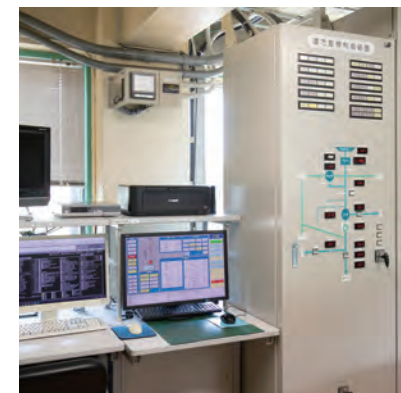
遠方監視装置
